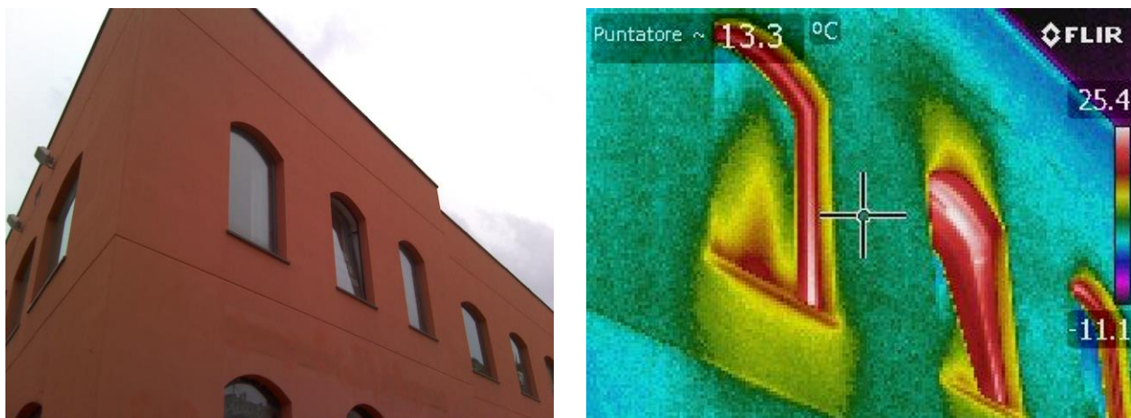
Figura 1 – Rilievo termografico del prospetto Nord/Ovest – 1
